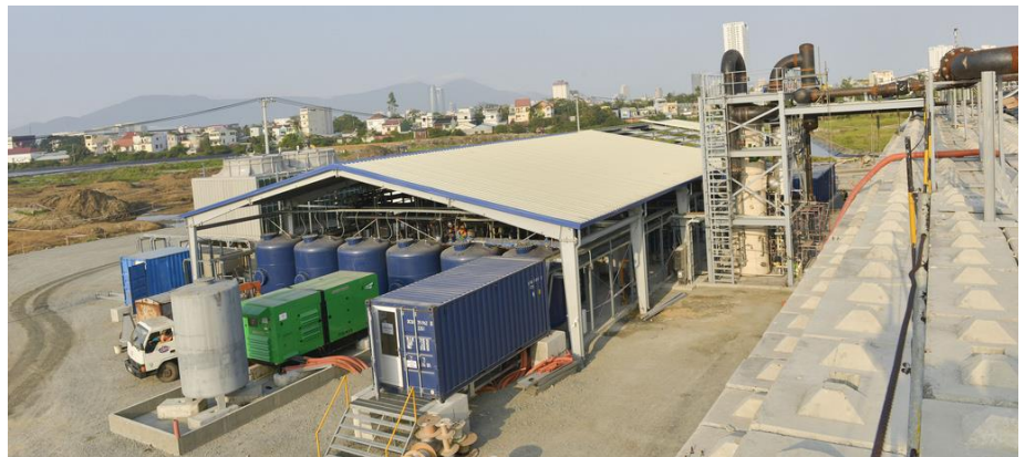
Nhà máy xử lý nước và khí thải ở đầu bắc mỏ xử lý
